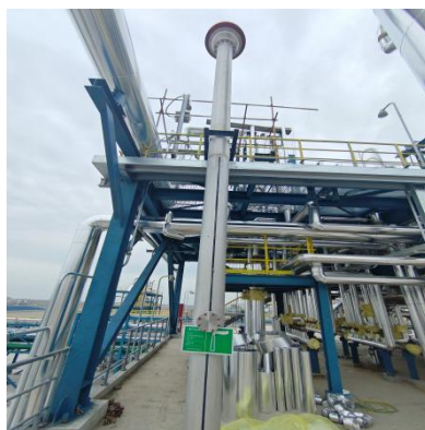
DA002 PPDA 进料废气排放口
