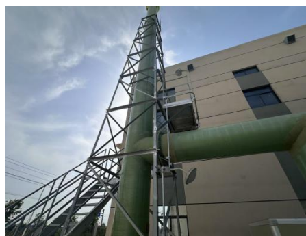
DA004 污水处理站废气排放口
