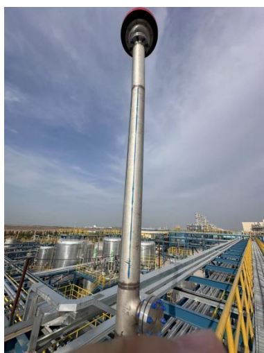
DA005 罐区废气排放口
