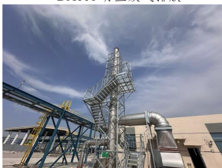
DA003 危废库废气排放口
