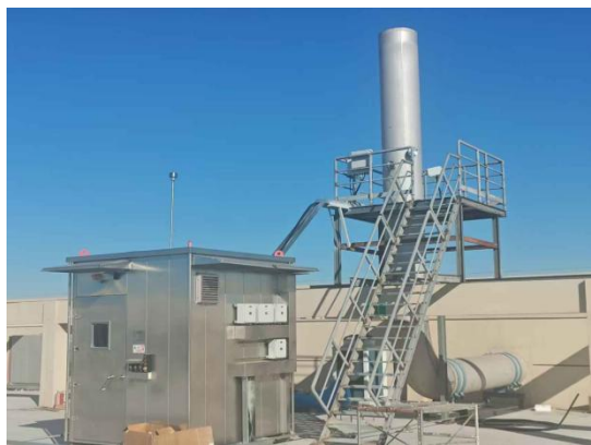
DA001 纺丝废气排放口
